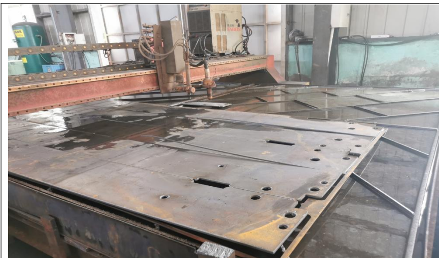
切割机及水箱除烟器
