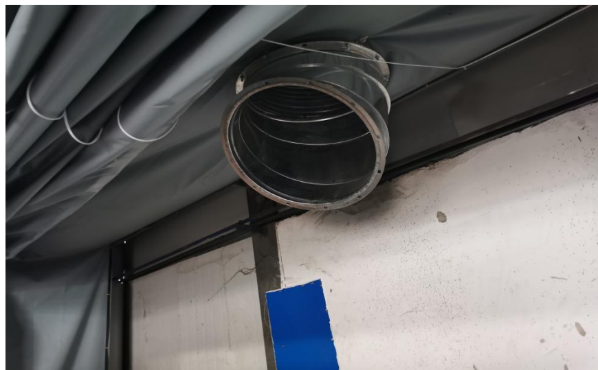
喷漆房收集口
